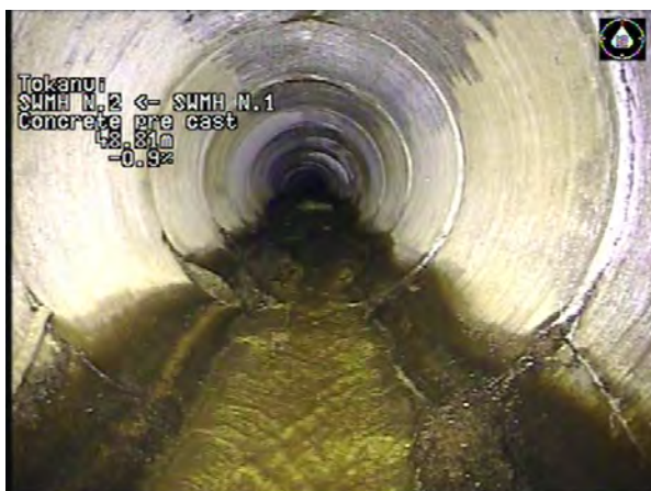
MH N.1 To MH N.2_7414f722-c10b-4872-ae14-51277d6b977b_20230424_10 0020_389.jpg, 00:12:40, 48.81m
