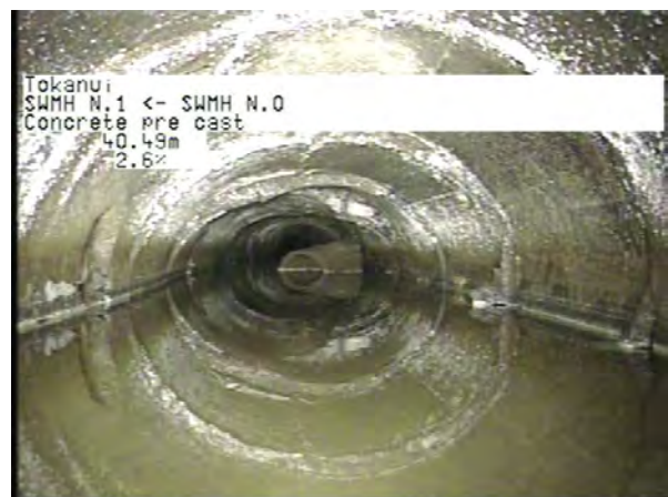
MH N.0 To MH N.1_f65822e3-23f9-4c1c-b0bf-5ee59af7f06b_20230406_160404_490.jpg, 00:11:22, 40.49m
