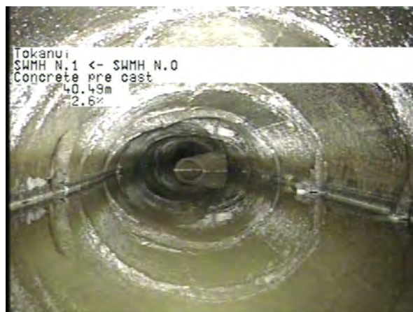
MH N.0 To MH N.1_f65822e3-23f9-4c1c-b0bf-5ee59af7f06b_20230406_160404_490.jpg, 00:11:22, 40.49m
