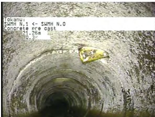
MH N.0 To MH N.1_21630247-33fe-4858-a748-056b93b7cd26_20230406_15 5716_905.jpg, 00:05:46, 21.26m
